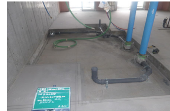
■給排水転がし配管
